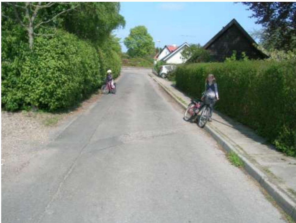
Eksempel 2. Trafikklasse T1 Restlevetid: 29 %
