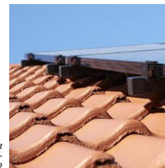
Udragende bæreskinner indfarvet og forsynet med plastpropper der forhindrer, at bæreskinnerne visuelt springer i øjnene
