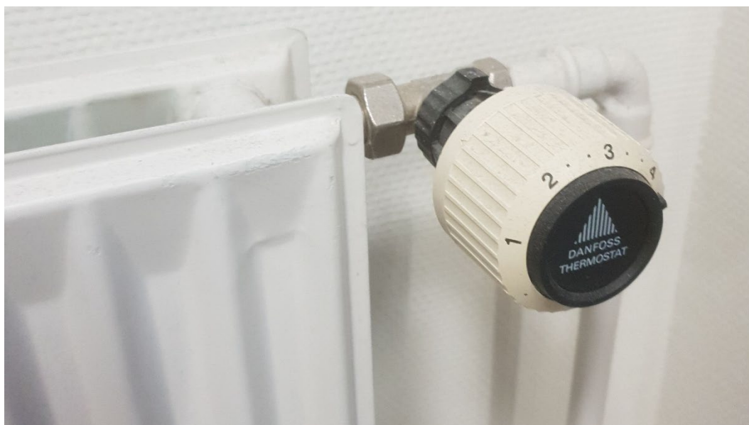
Billedet viser en radiator med termostat på rådhuset – Foto: Randers Kommune
