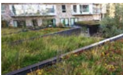
Eksempel på flade tage med sedum
