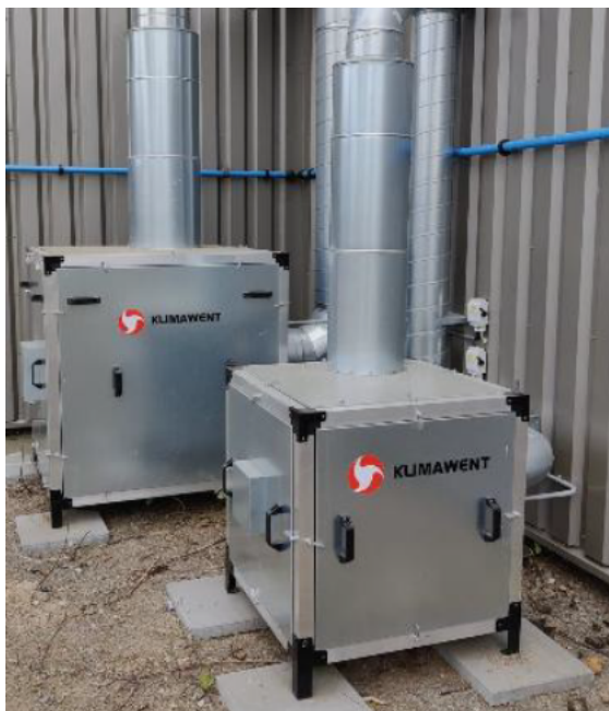
Billede 2: Vejledende eksempel på procesudsugningsanlæg.
