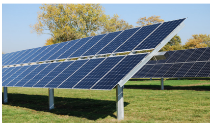
Solpaneler monteret på stativer med trackermekanisme
