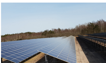
Solpaneler monteret på faste stativer
