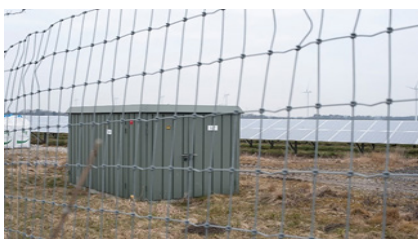
Eksempel på en teknikbygning. Her er en typisk transformerkiosk.
