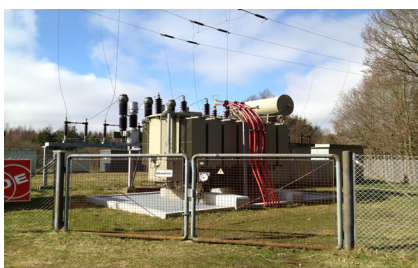
Eksempel på en transformerstation. Her uden lynafleder og teknikbygning.
